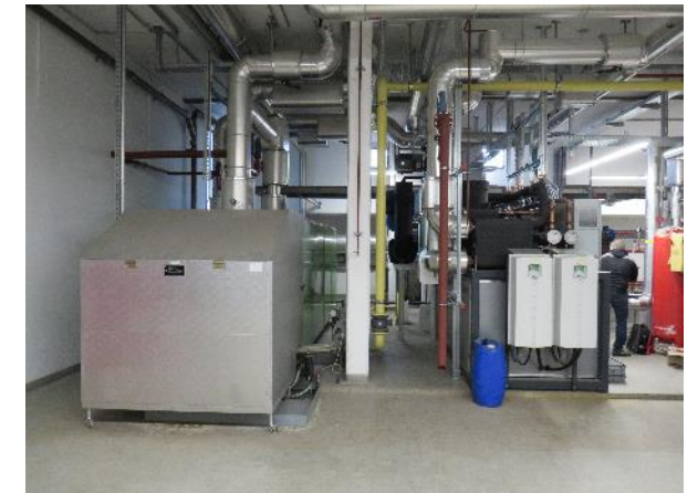
Potenzialanalysen für Wärmerückgewinnung
